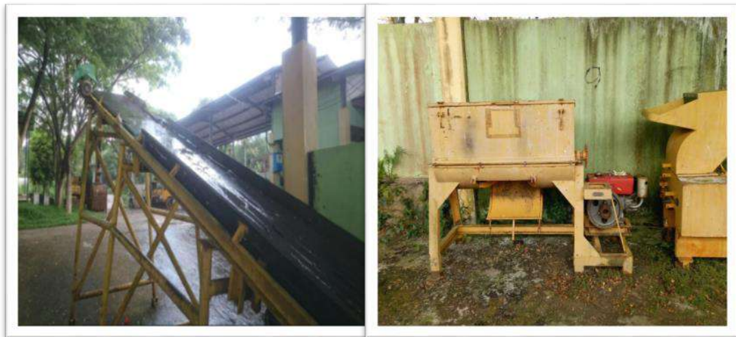
Gambar 2.13 Belt Conveyor dan Mesin Pencacah di TPA Sampah Regional Payakumbuh
